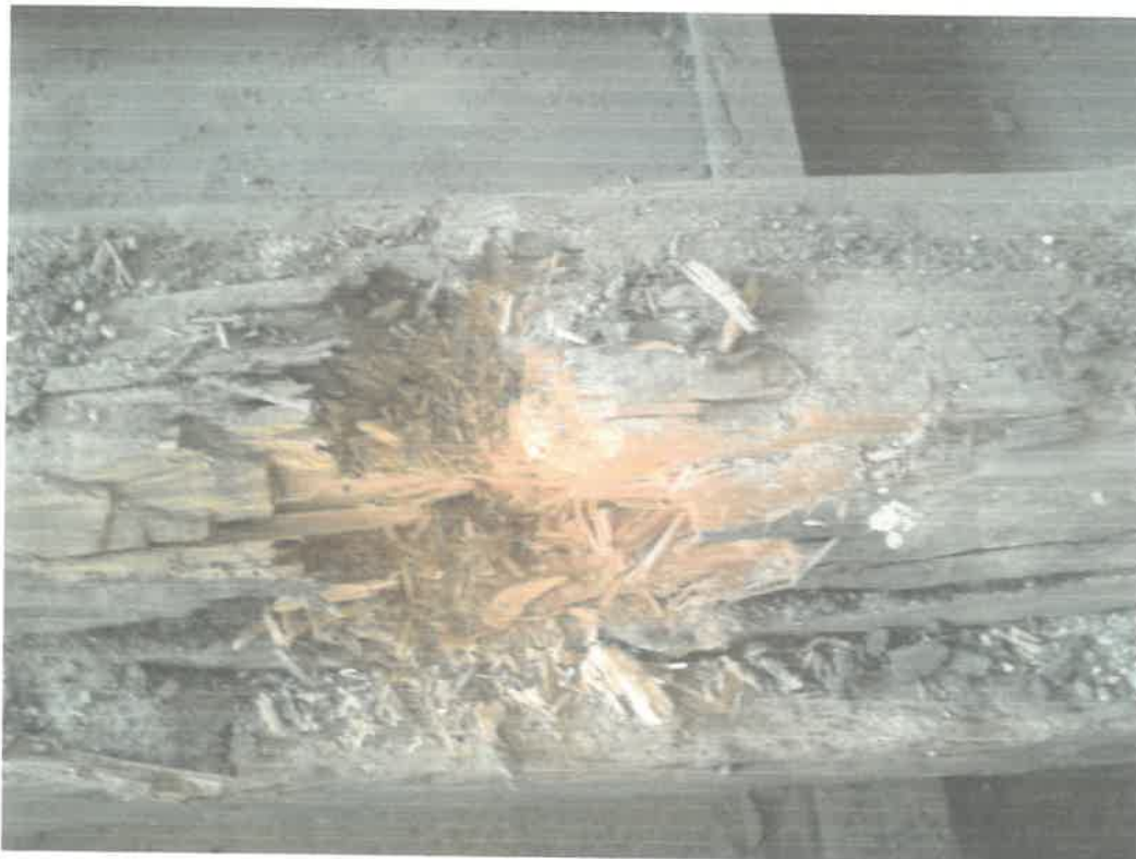
Fot. 2 Pośrednia belka stropowa, widoczna korozja biologiczna spowodowana zawilgoceniem konstrukcji i braku wentylacji konstrukcji stropu całkowite uszkodzenie elementu.
