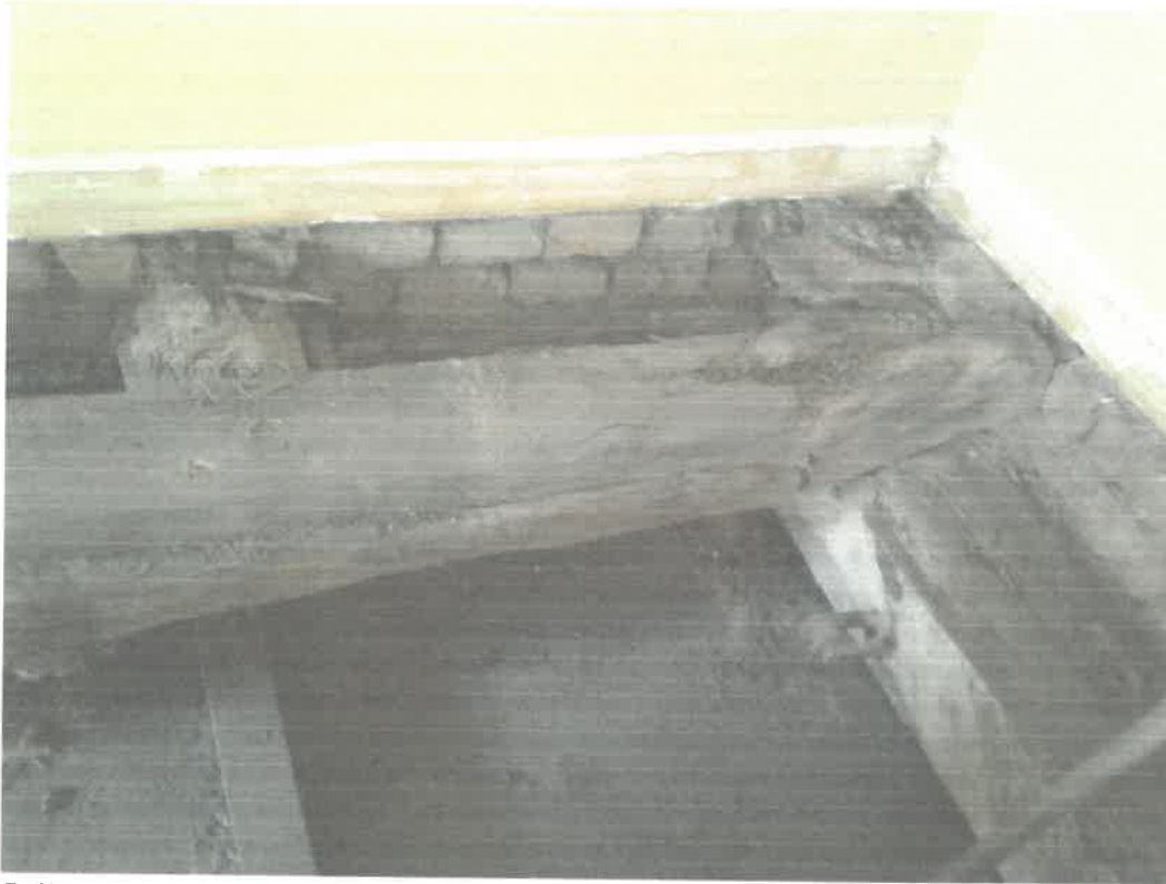
Fot. 1 Belka stropowa zewnętrzna 16x22cm, widoczna korozja biologiczna spowodowana zawilgoceniem konstrukcji i braku wentylacji konstrukcji stropu całkowite uszkodzenie elementu.
